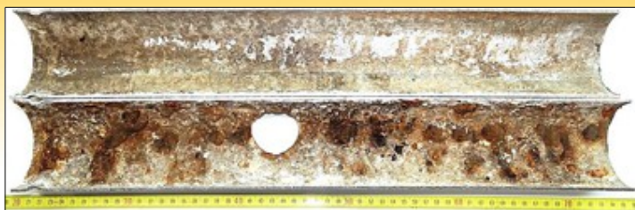
Figuur 7: doorgezaagde buis van sprinklerleiding met corrosieproducten aan de onderkant. De holte in de onderste helft is de locatie van een sprinklerkop
